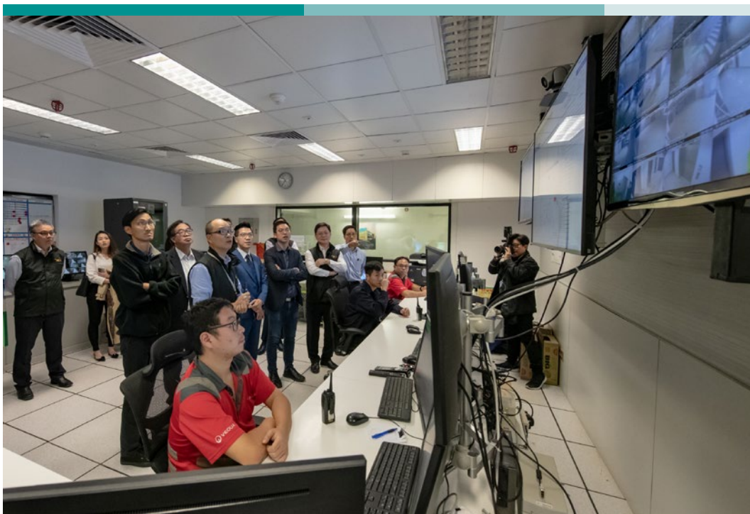
工务小组委员会委员参观启德发展计划区域供冷系统北厂的控制室。
